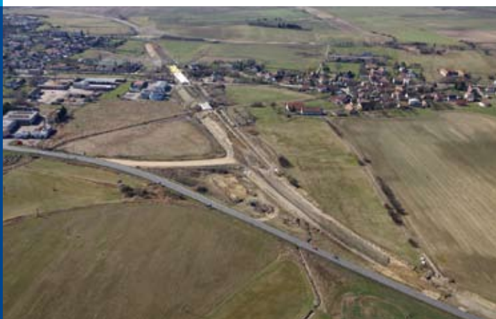
Pohled na trasu od začátku obchvatu směrem k ČOV a na Brno
